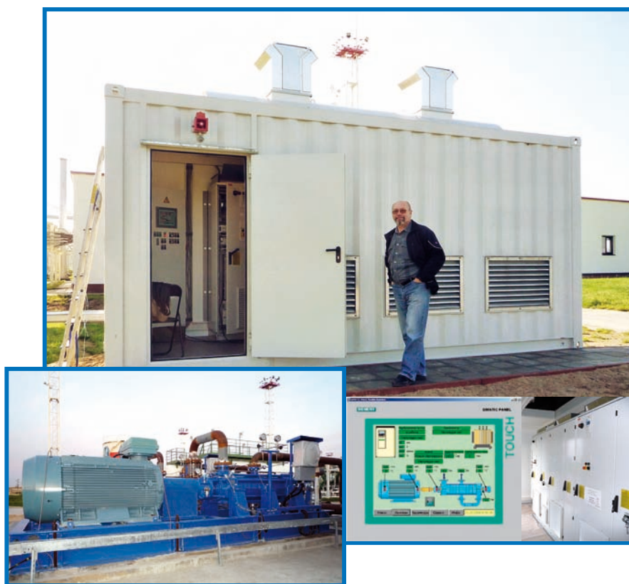
■ Инжекторные насосы и контейнер с системой управления
