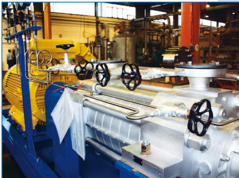
■ Комплектный агрегат питающего насоса высокого давления после приемки.
